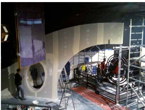
Une véritable gageure : assurer les travaux tout en maintenant l'accueil du public.
